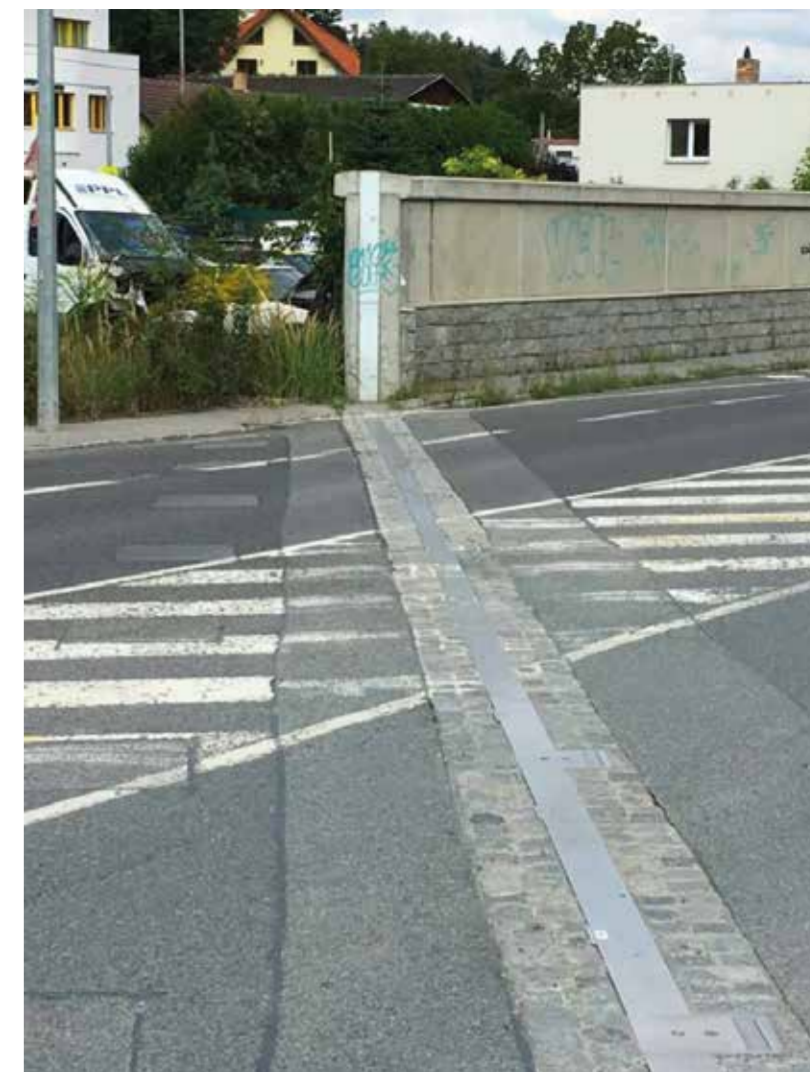
MANUEL PORT VED VEJ - 'STOP LOGS'
