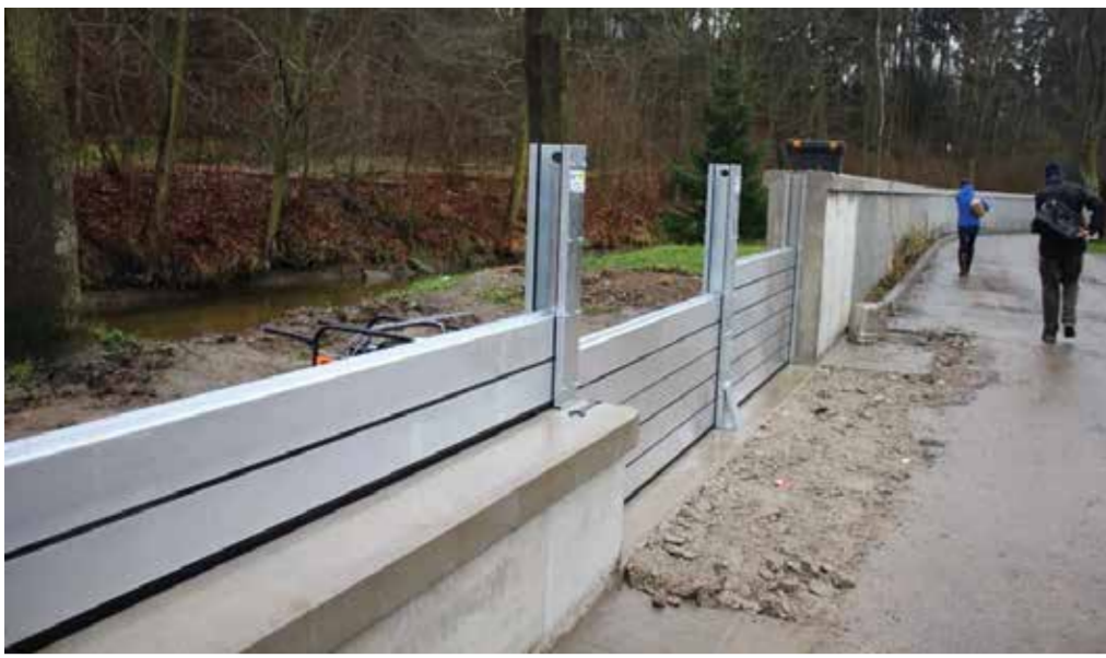
EN UDBYGELSESMULIGHED FOR MURENE ER AT FORBEREDE IMPLEMENTERING AF I-PROFILER I MUREN UNDER DETAILFASEN, SÅ DISSE ENKELT KAN UDVIDES I HØJDEN. FOTO VISER OPBYGNINGEN AF 'STOP LOGS'
